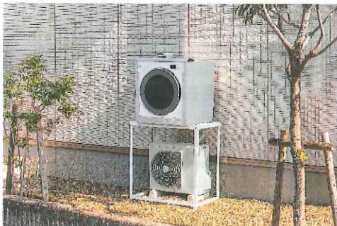
エアコン室外機上
